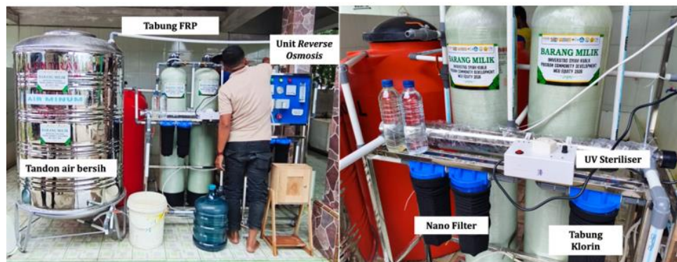
Gambar 4. Instalasi pengolahan air bersih yang dipasang di Desa Dayah Leubu, Kecamatan Ulim, Pidie Jaya
