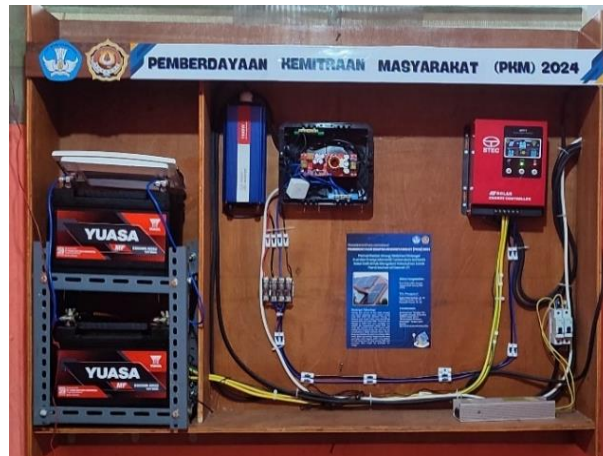
Gambar 5. Hasil Box Kontrol yang terpasang di lokasi Mitra
