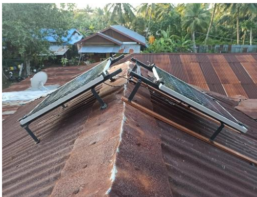
Gambar 6. Panel Surya yang terpasang
